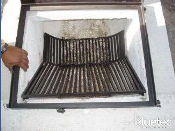
Rejilla para sólidos Hotel Atitlàn
