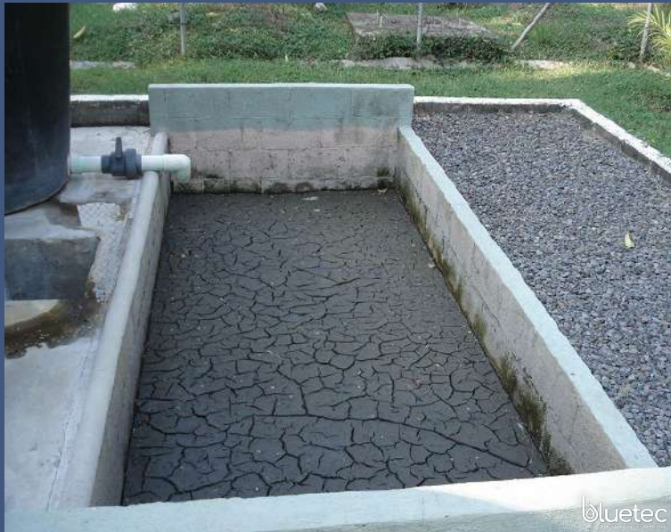
Patio de Secado y Válvula para Drenaje Parque Acuático Aqua-Ventura
