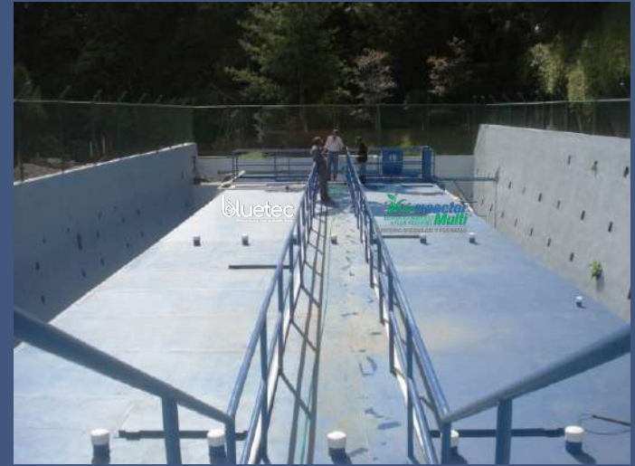
Vidarreactor MULTI Cabecera Municipal de Fraijanes
