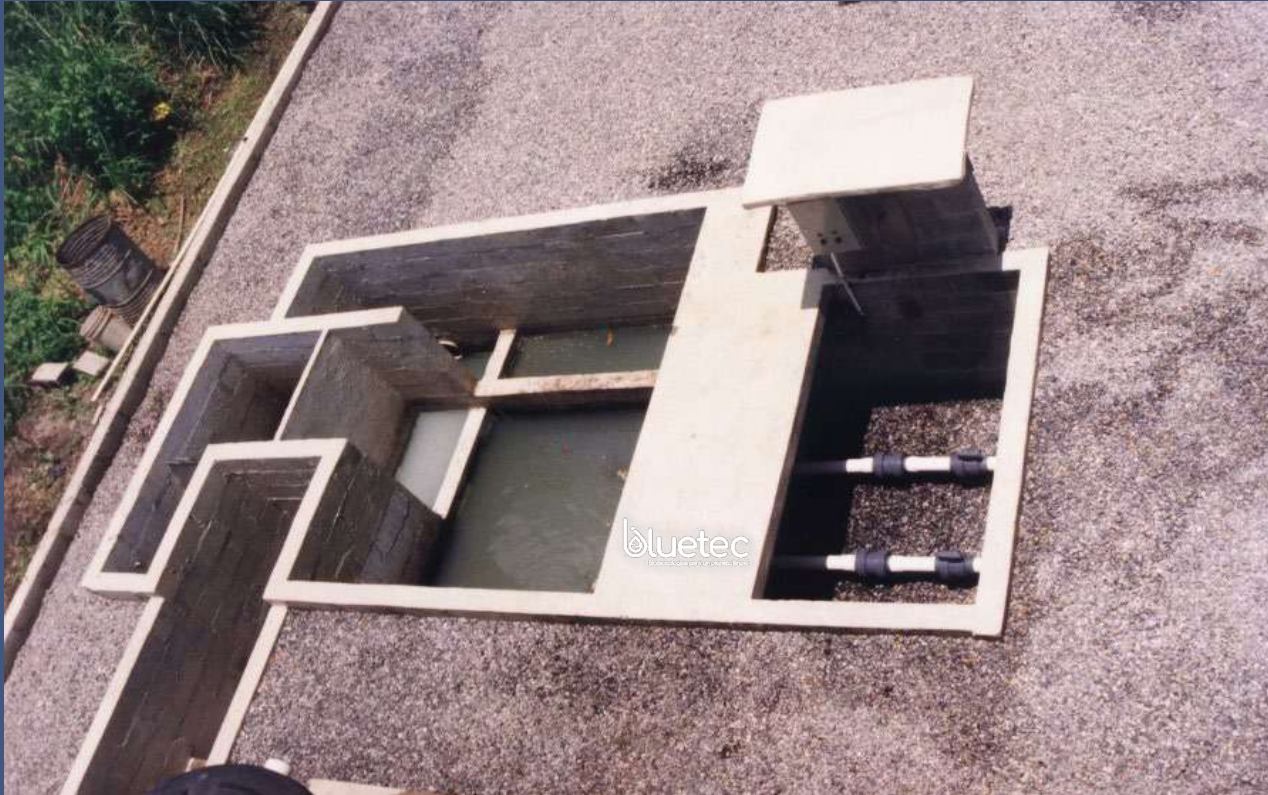
Estación de bombeo, Parque Acuático AquaVentura, - Masagua - Guatemala
