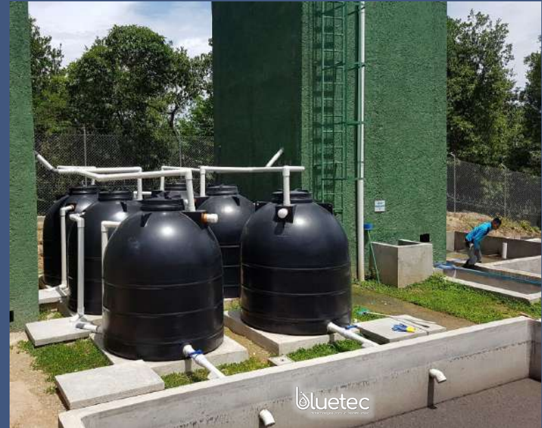
Biofiltro de olores, lecho fijo (compost) Vidarreactor ULTRA - Nova Cayalá - Guatemala
